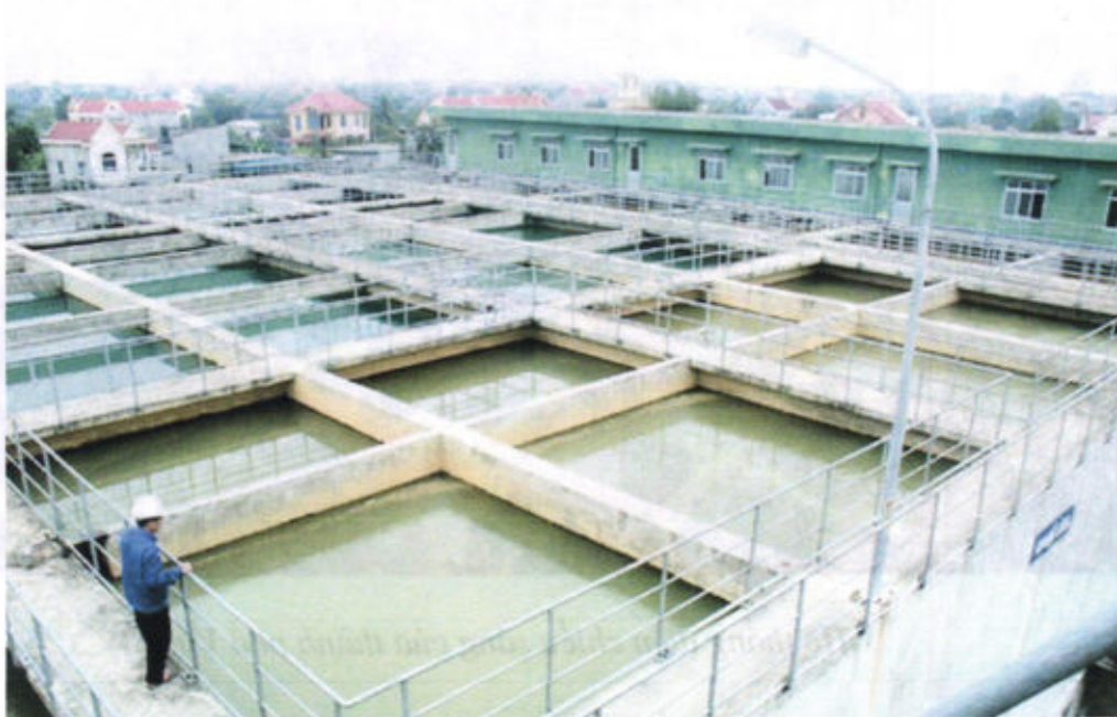
Trạm cấp nước
